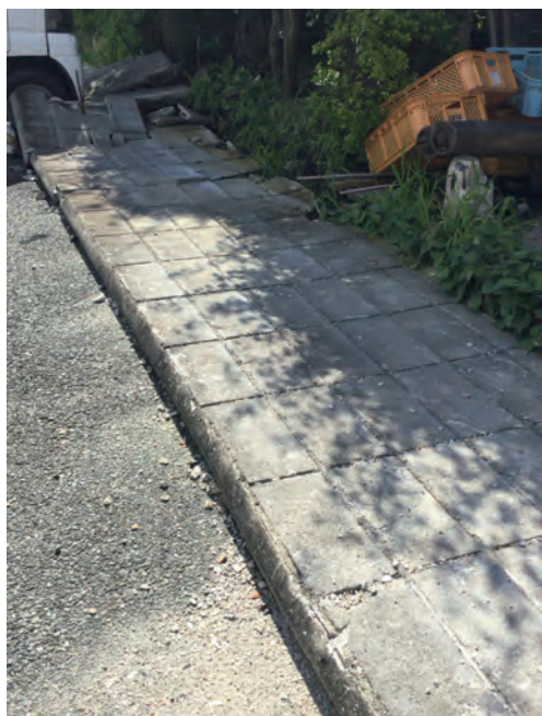
地震によりブロック塀が倒壊
