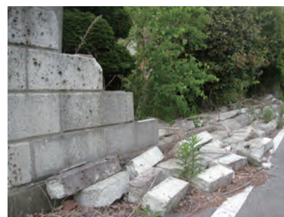
地震により石塀が倒壊
