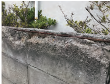
割れや鉄筋の露出がみられる塀
