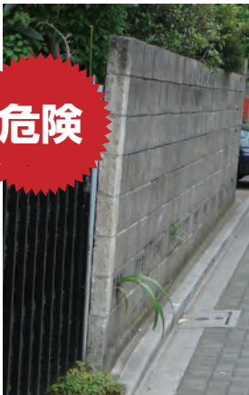
傾いている危ない塀
